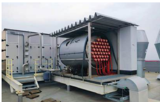
Biofinomító, Dunaföldvár - 1 db Ecotherm elektromos kazán (1440 kW)
