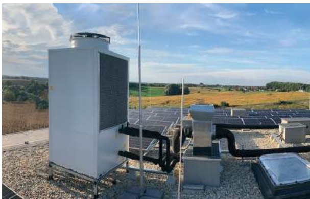
Gébárti Lakópark, Zalaegerszeg - 3 db Enerblue Orange HT hőszivattyú, 3 db Hoval fűtési puffertartály, 3 db Hoval HMV-tároló
