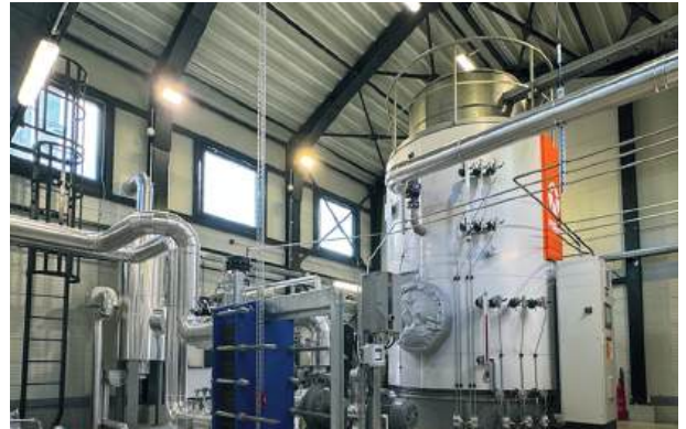
Alteo Energiaszolgáltató Nyrt. Kazincbarcika and Tiszaújváros - 6 MW Parat electrode boilers at both plants
