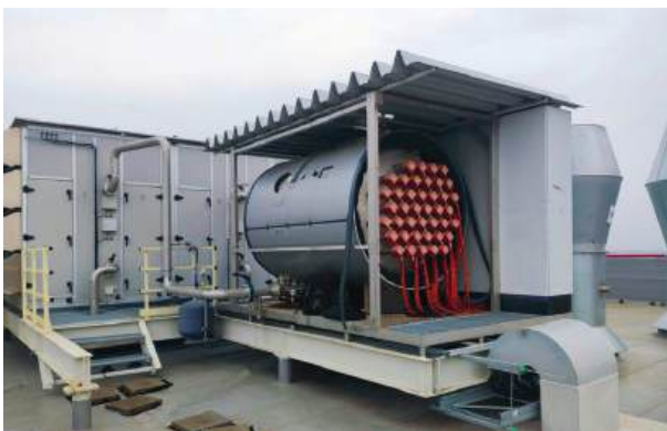
Biofinomító, Dunaföldvár - 1 pcs Ecotherm electric boiler (1440 kW)
