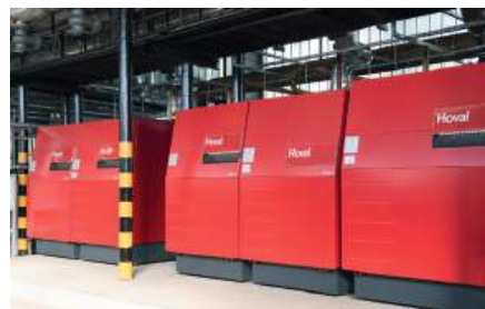
Mérgező úti Fűtőmű, Gyöngyös - 3 pcs Hoval UltraGas® gas condensing boilers
