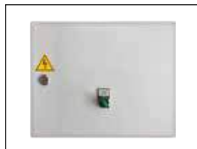
Kép: Kiegészítő zónavezérlő szekrény
